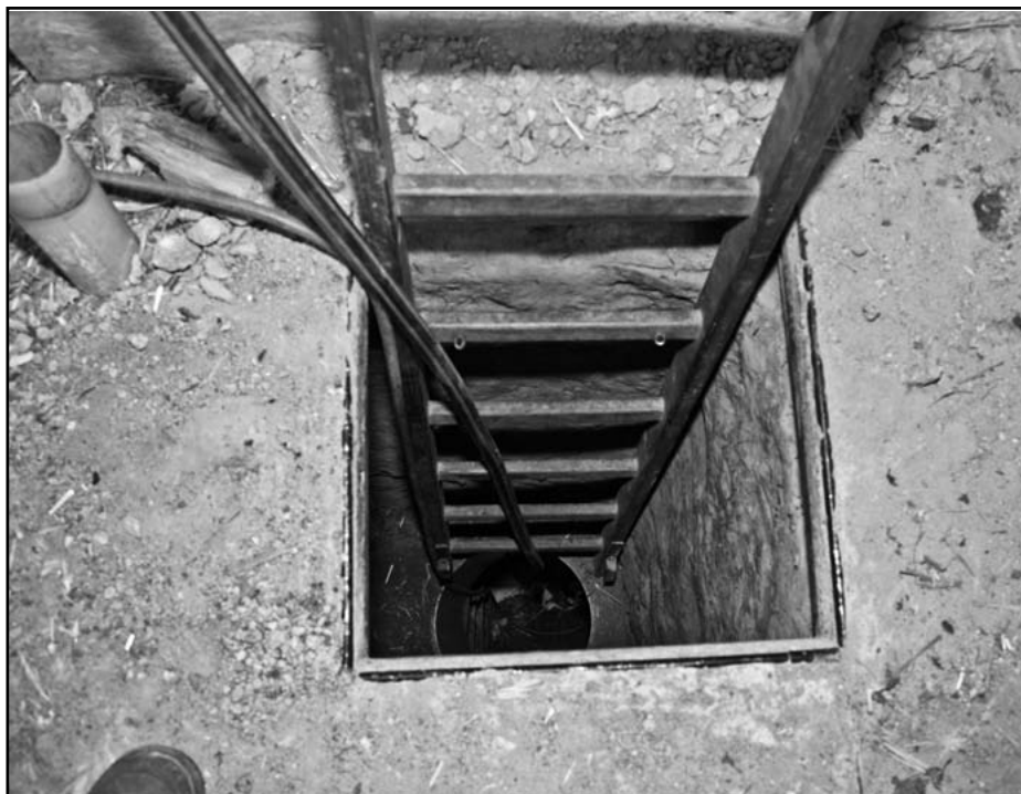
Klein, aber oho: Der Einstieg in den Tunnel. Das Rohr oben links war der Anfang der Frischluftleitung. Foto: Hubert Perschke
