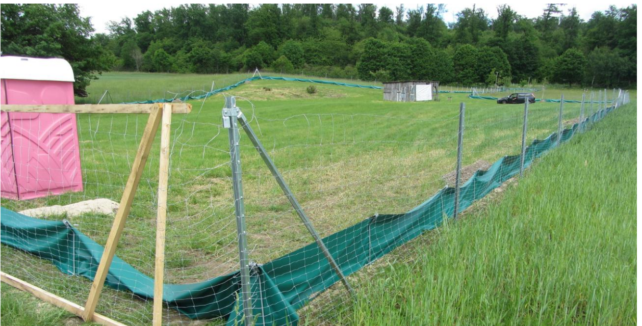
Zustand am 25.5.2026 (deutlich nach Mitte Mai): Neu errichteter Reptilienzaun, aber noch ohne Sandanhäufelung, daher für Zauneidechsen durchlässig (Folie mit Lücke über dem Boden).
