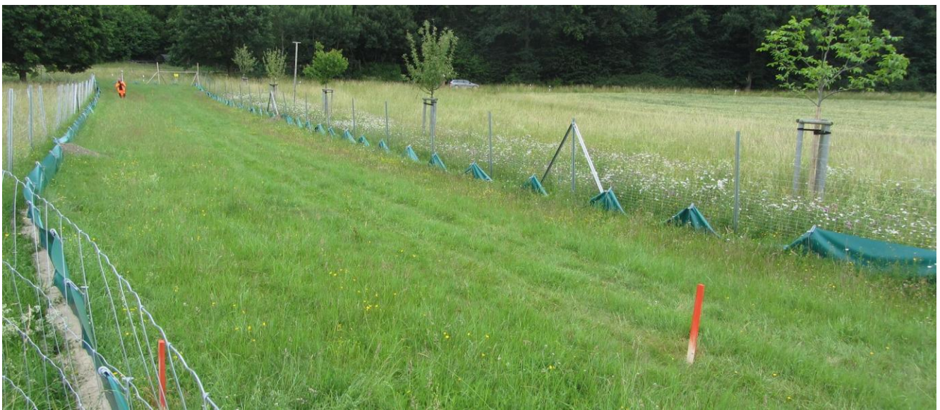
Aufnahme vom 15.6.2026: Zerstörte Reptilienzäune am Bauwerk 3
